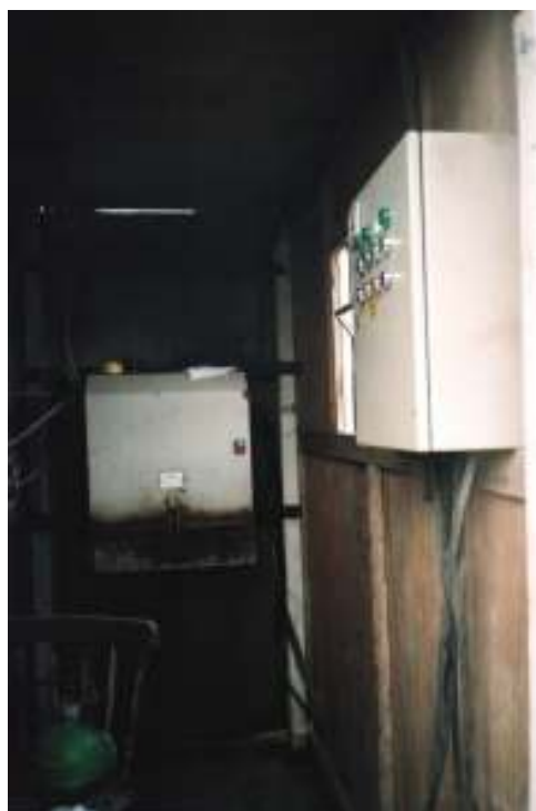
Figura 16 Foto Interior de Quadro de Comando
